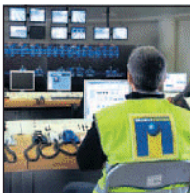
La centrale di comando
